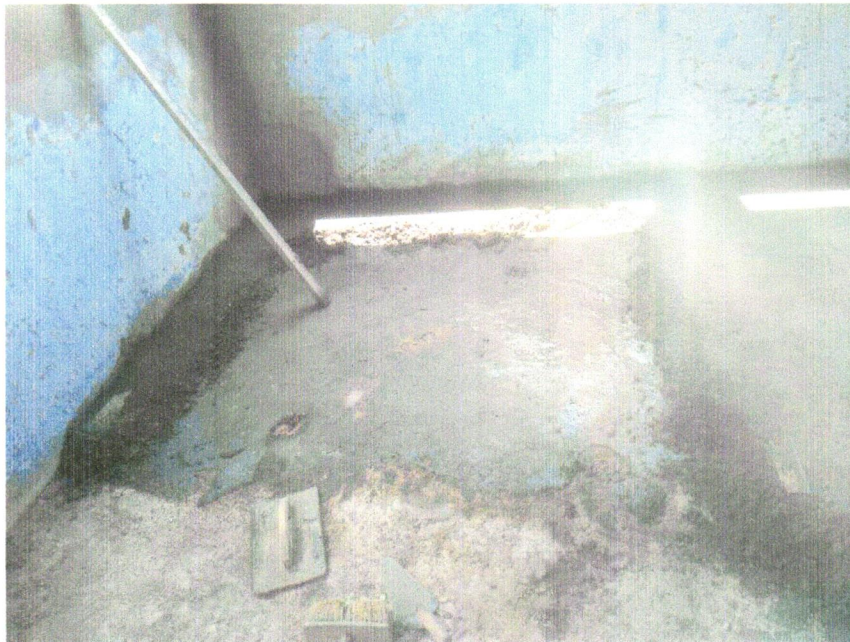
FOTO 18 – Contrapiso em argamassa traço 1:4 (cimento e areia), preparo mecânico com betoneira 400l, aplicado em áreas secas sobre laje, não aderido, acabamento não reforçado, espessura 5cm. Af_07/2021
