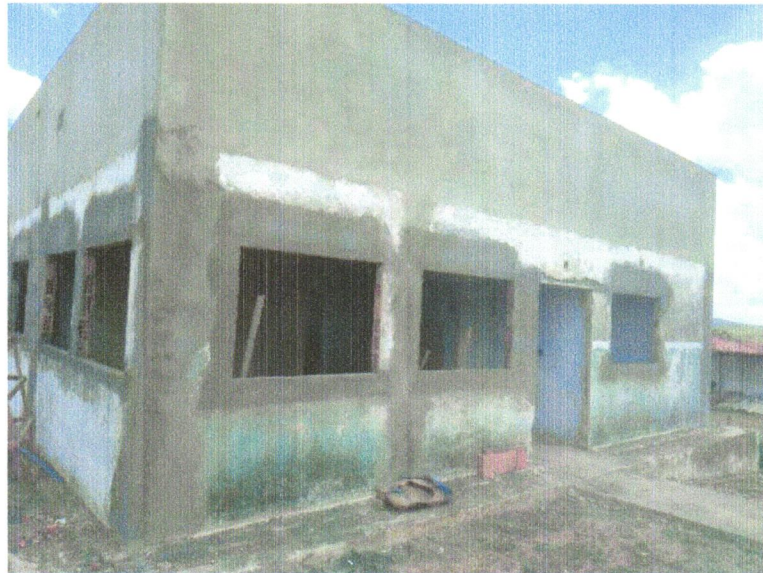
FOTO 15 - (COMPOSIÇÃO REPRESENTATIVA) EXECUÇÃO DE ESTRUTURAS DE CONCRETO ARMADO, PARA EDIFICAÇÃO HABITACIONAL UNIFAMILIAR TÉRREA (CASA EM EMPREENDIMENTOS) FCK=25MPA. AF_01_01/2017
